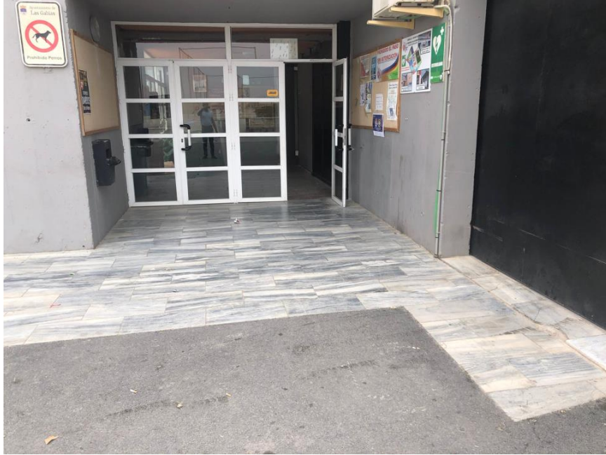
Puertas de acceso al pabellón con anchuras inferiores a 0'80m.
