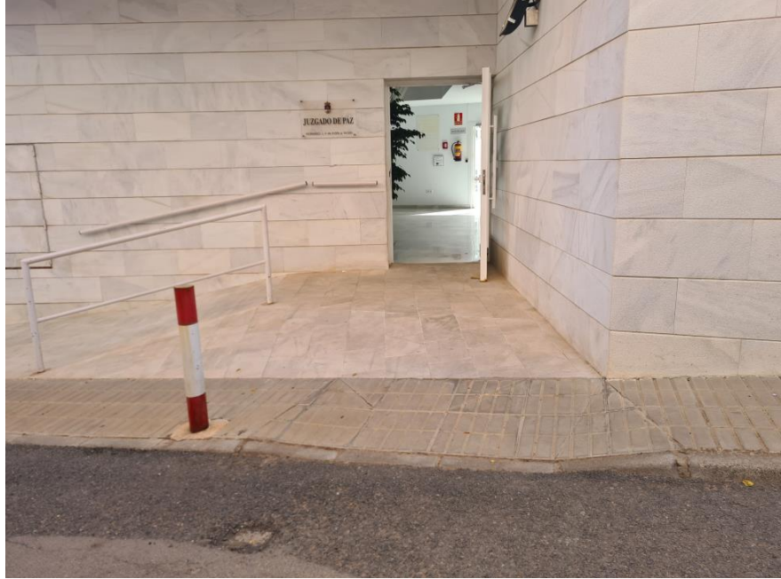
Acceso a los Juzgados desde Calle Marañoa donde falta doble pasamanos en la rampa
