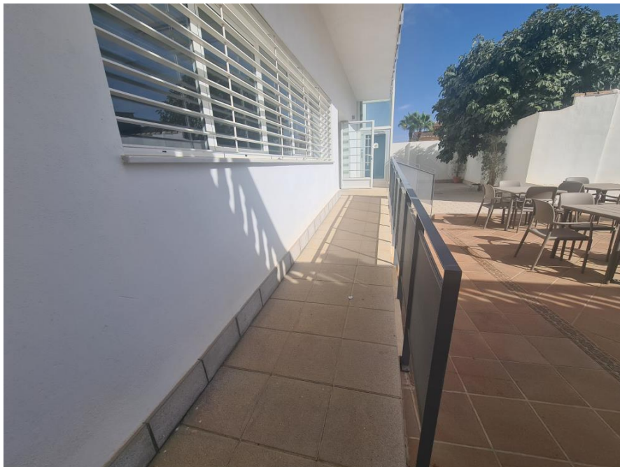
Rampa del patio del Hogar del Pensionista sin doble pasamanos, zócalo y señalización
