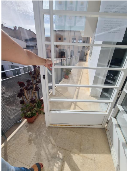
Apertura de la puerta de la planta alta que obstaculiza el paso desde el elevador al edificio
